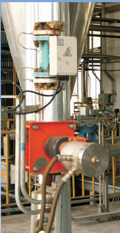
Installation an einer pneumatischen Förderleitung, mit DYNAvel Geschwindigkeitssensor.
