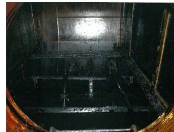
Fig. 3 Intérieur d'un dessaleur ayant accumulé une grande quantité de dépôts
